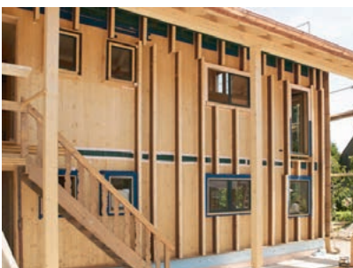
Schaffung einer Dämmebene auf der Massivholzwand durch STEICO wall als schubsteife Unterkonstruktion.
