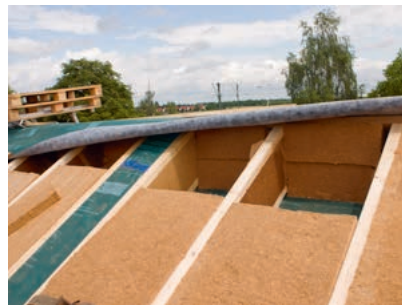
Blick in die Dämmebene der Dachkonstruktion. Vorgedämmte STEICO joist Stegträger mit STEICO flex Dämm-Matten.
